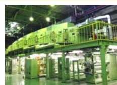
埼玉工場 新塗工設備
