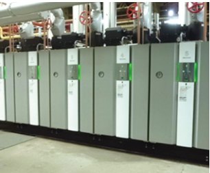
都市ガスボイラー
