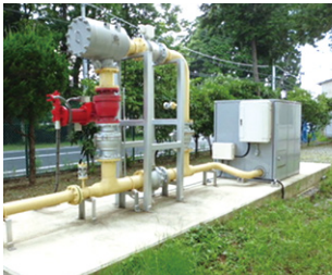
都市ガス整圧器
