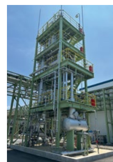
溶剤精留装置外観
